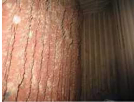
図 1-3 ボイラ過熱器における灰付着例
