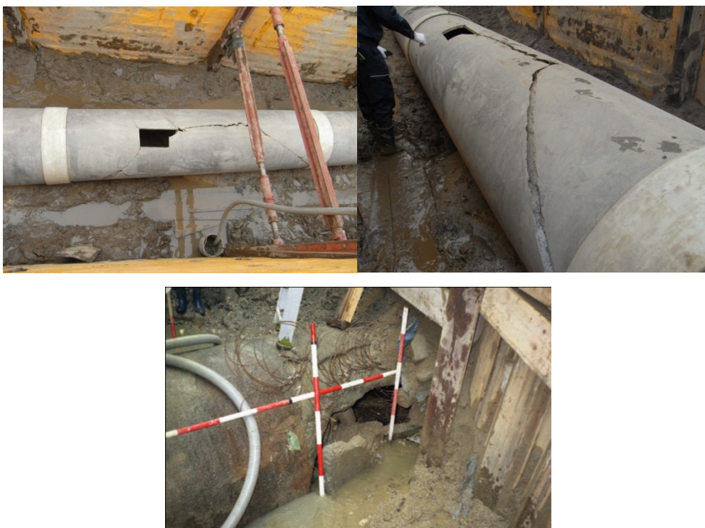
Fig. 1-5 パイプラインの突発事故状況（上：遠心 FRPM 管※ 1 ，下：PC 管※ 2 ）
