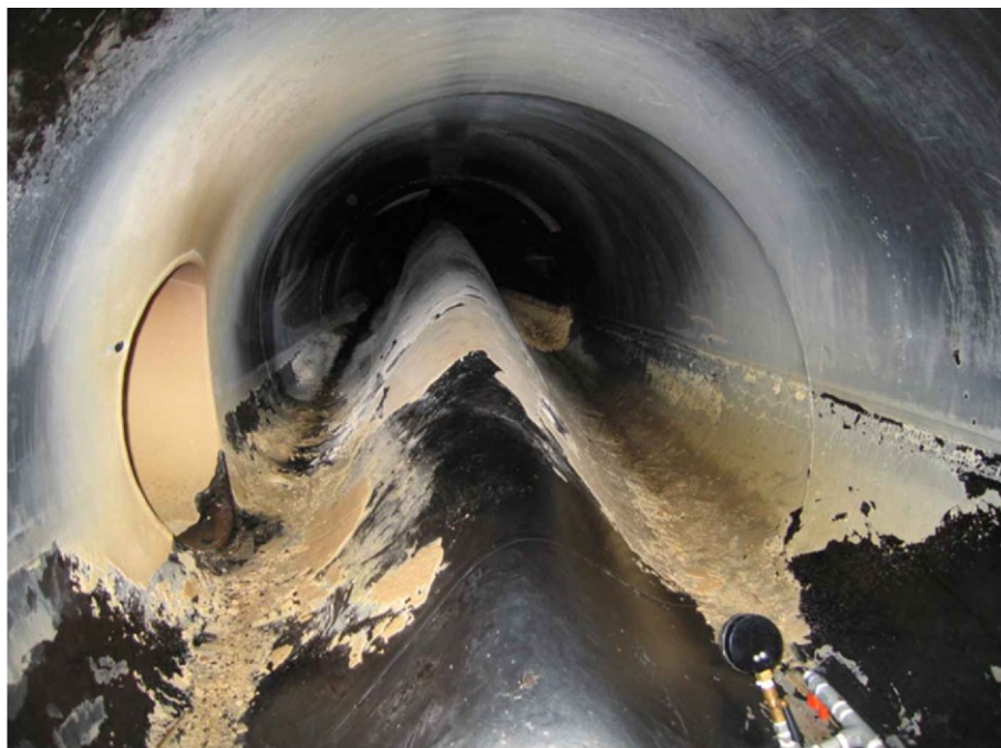
Fig. 1-14 更生管（鋼管）の座屈破壊事例
