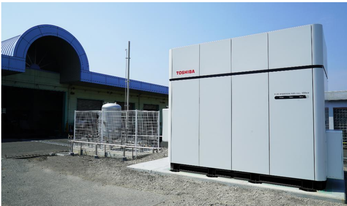
図 5 山口県周南市の地方卸売市場に導入された純水素燃料電池 (100kW) の外観写真[13]
