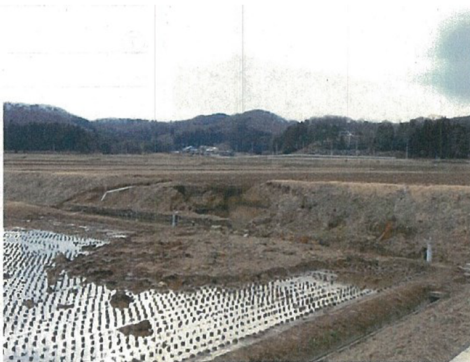
Fig. 3.3 洗掘痕(2) 畦畔法面の洗掘 (提供：須賀川市, 2011年3月24日撮影)
