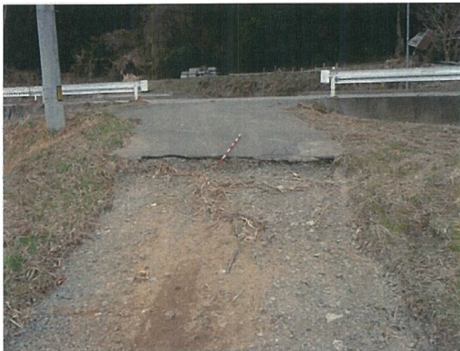
Fig. 3.2 洗掘痕(1) 農道の洗掘 (提供：須賀川市, 2011年3月24日撮影)
